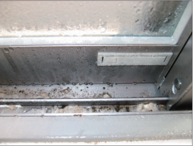
窓ガラス、サッシの結露
